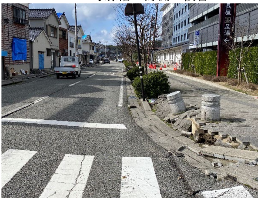
海沿いの道路の液状化
