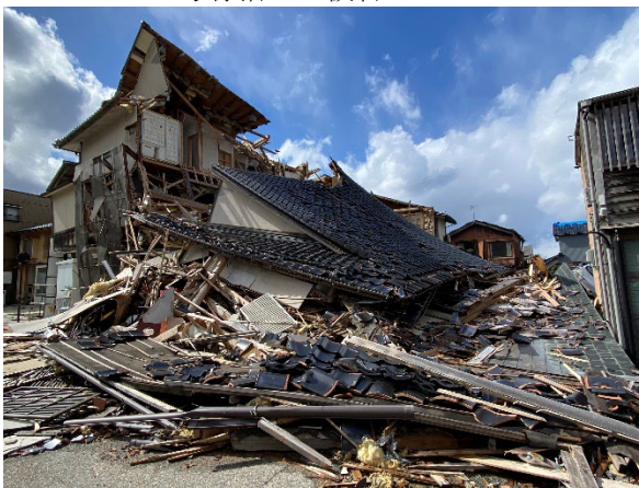
1号線沿い海側の被害
