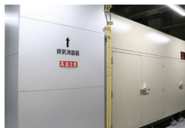
非常用発電機
