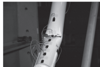
写真 4 鋼管部局部座屈発生(A0E0-L)
