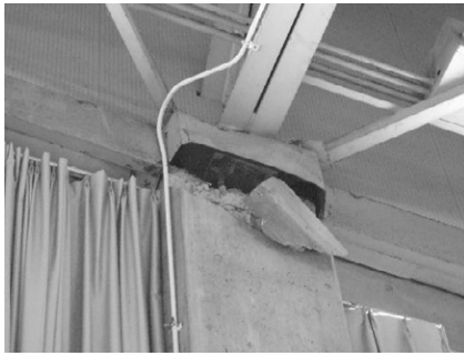
写真1 定着部における側方破壊
