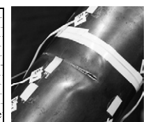
写真 2 亀裂状況 (C454P)
